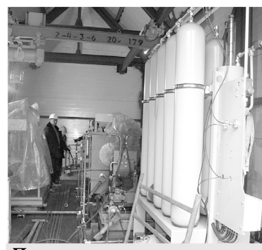
Помещение гидравлики БЗУ
